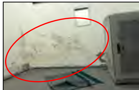
Bilik Server Kedutaan Besar Malaysia Di Hanoi, Vietnam - Kesan Resapan Air Pada Dinding (16.09.2015)
